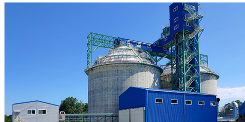
영동 1호기 화력 바이오매스 SILO 및 설비
